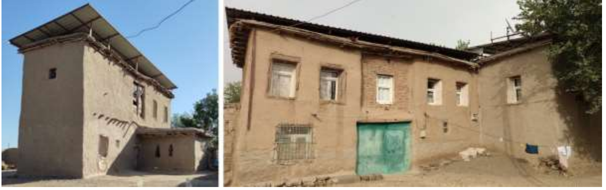
Şekil 3. Kerpiç binaların toprak çatılarının üzerine eklenen metal çatılar (solda 32 ve sağda 69 nolu kerpiç konutlar) (Serpil Ö. Biroğlu - 2022)
