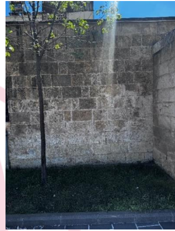
Şekil 14. Gaziantep hamamlarının cephelerinde gözlemlenen yüzey kayıpları
