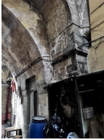
Şekil 15. Gaziantep hamamlarının cephelerinde gözlemlenen derz boşalmaları
