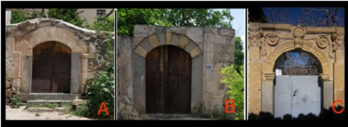
Şekil 8: Yapısal bütünlüğü bozulmuş basık kemerli avlu kapıları; 131 nolu avlu kapısı (A), 154 nolu avlu kapısı (B), 58 nolu yeni inşa edilmiş evin avlusu için yerinden sökülüp taşınan avlu kapısı (C) (İ. Acar Ata - 2022)
