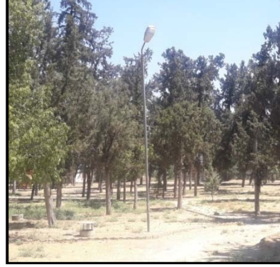
a) Aydınlatma elemanları
